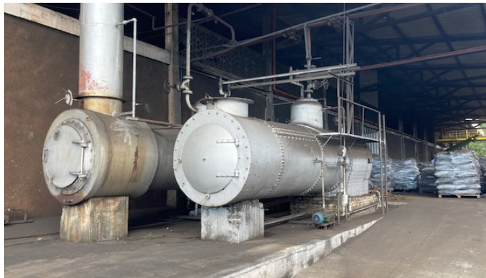
Caldeira de 2000 e 1500 quilos de vapor
