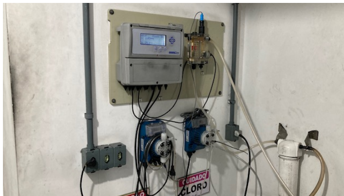
Dosador de Cloro
