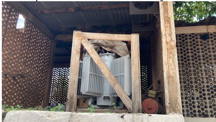
Transformador de 500 KwA
