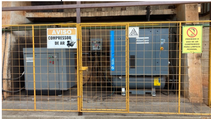
Compressor de Parafuso
