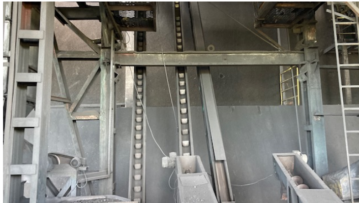
Transportador de caneca em aço carbono
