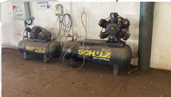
Compressor de ar de 200 e 425 litros
