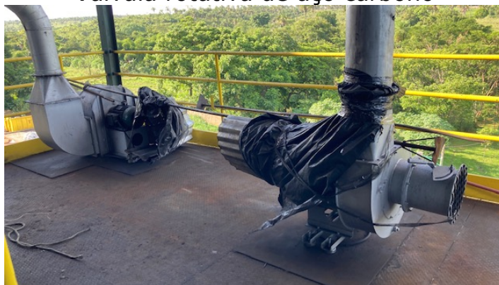
Ventilador da turbina da caldeira
