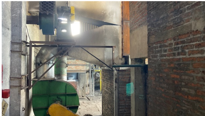
Exaustor e ventilador de ar quente
