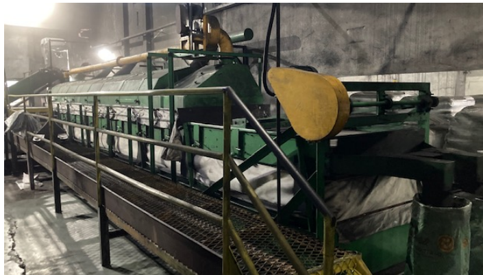
Secador vibratório contínuo
