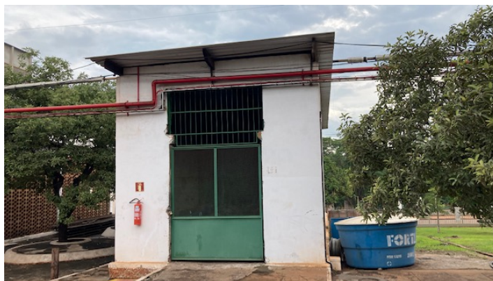
Casa de motores
