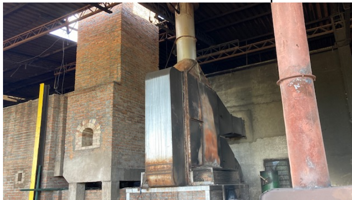
Exaustor e ventilador de ar quente
